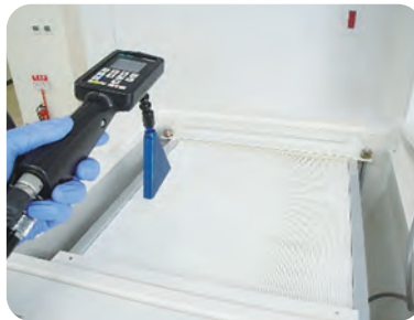
HEPAフィルタ性能試験(透過率試験)
